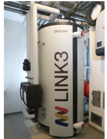
Modernisierung eines Wohnhauses: Ein DUOLINK-Cool Schichtenspeicher arbeitet im Verbund mit einer Wärmepumpe. © LINK3
